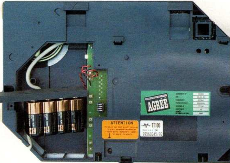
Le compartiment à piles du transmetteur téléphonique. Les fils torsadés en haut à droite sont les fils d'antenne qui n'ont pas encore été placés dans leur fourreau de protection rigide.
